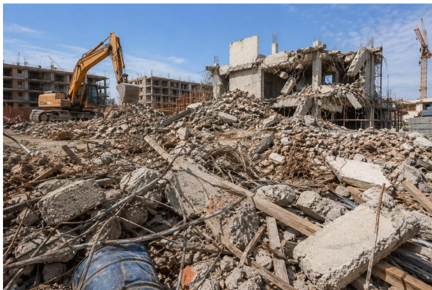
Slika 3 Nerazvrstani građevni otpad na gradilištu
