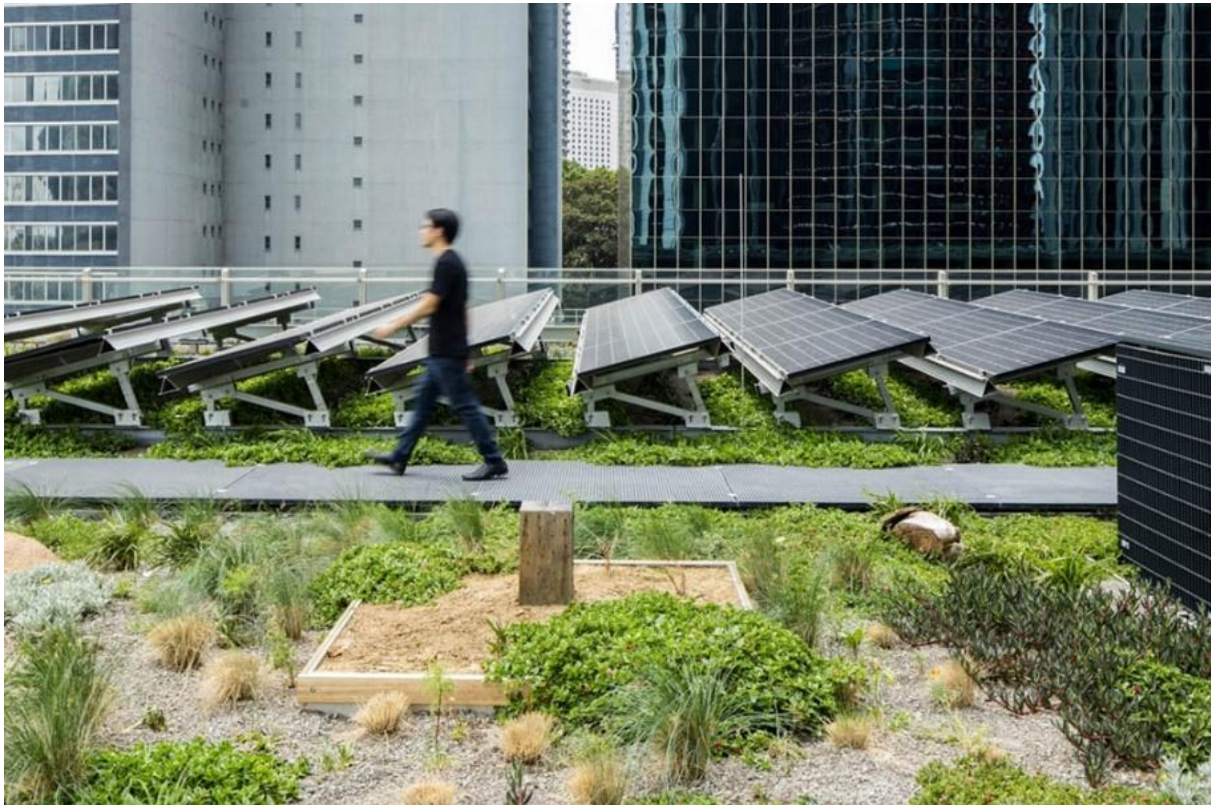
Slika 82 Primjer krova sa biosolarnim panelima na krovu, Daramu House, Barangaroo, Sidney (Tzannes, 2024)
